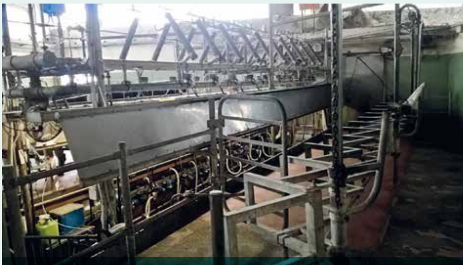
Figura 2 Sala di mungitura a spina di pesce con poste inclinate di 70° rispetto alla fossa del mungitore
